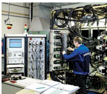
Prüfstand bei Siemens, Luhe-Wildenau.
